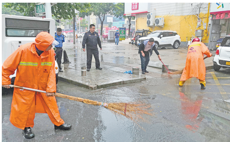
环卫工人在清理路面积水。
