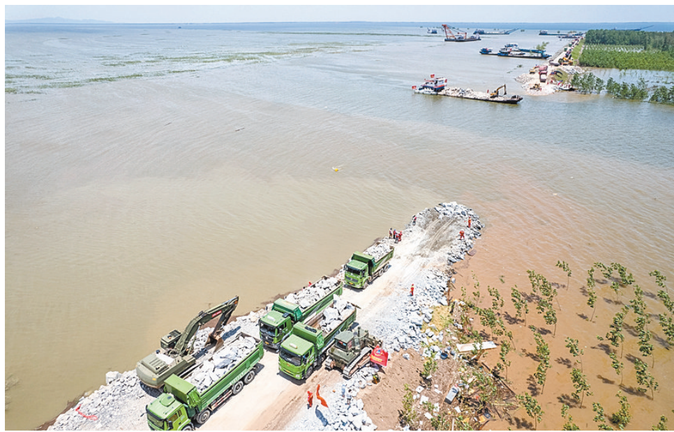
7月7日,在湖南省岳阳市华容县团洲垸洞庭湖大堤决堤现场,抢险车队排队进行
